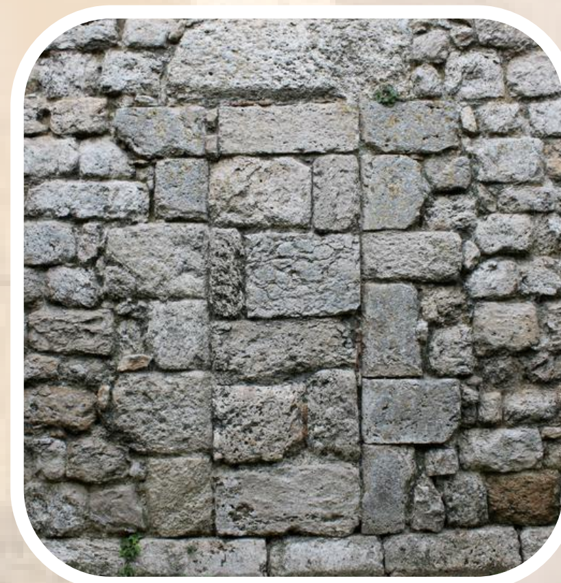
Vue de l'ancienne Absidiale - partie extérieure - (Qui est l'actuelle Sacristie), avec vue sur, probablement, une ancienne porte d'entrée (Désormais murée) de l'ancienne Absidiale.
