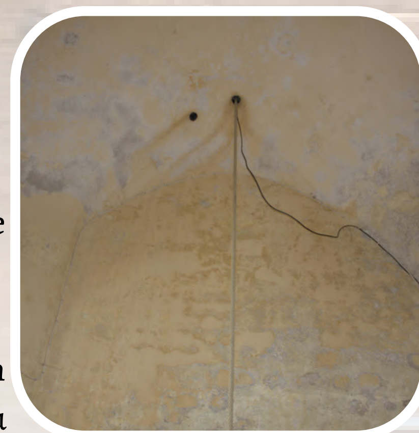
Vue de l'ancienne Absidiole (Qui est l'actuelle Sacristie), avec vue sur la corde de la cloche, ainsi que sur le câble de l'halogène du clocher.
